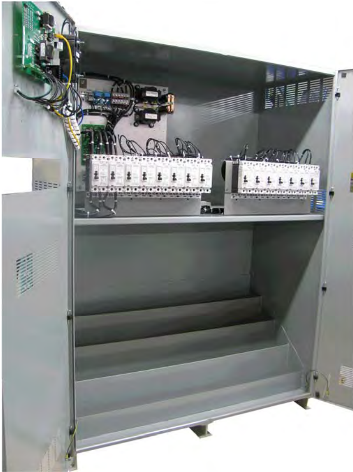
Chargeur avec distribution cc et compartiment de batterie
